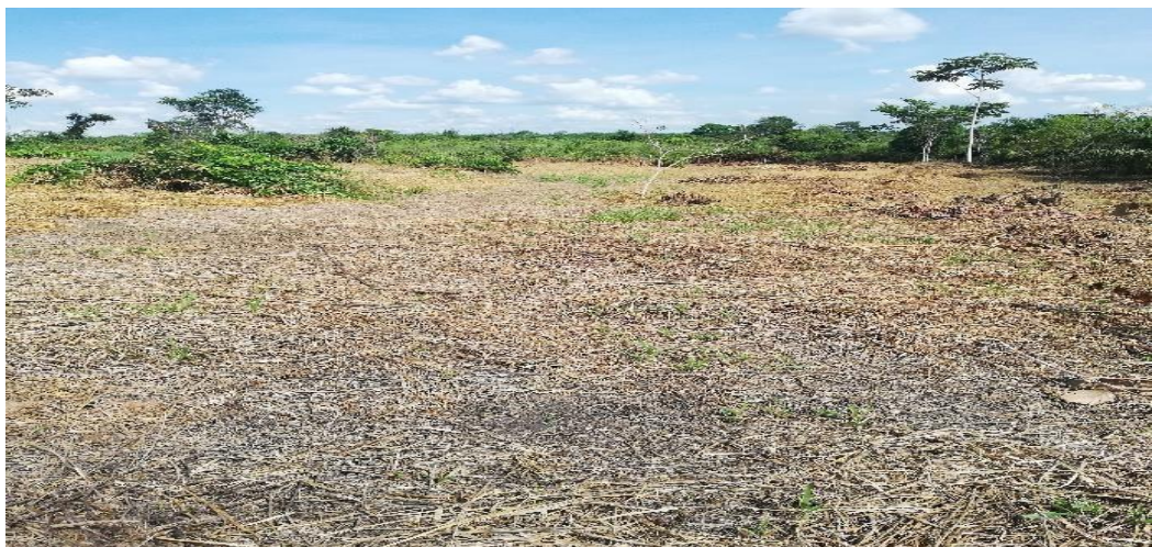
Figura 19 Preparación de Terreno 3
