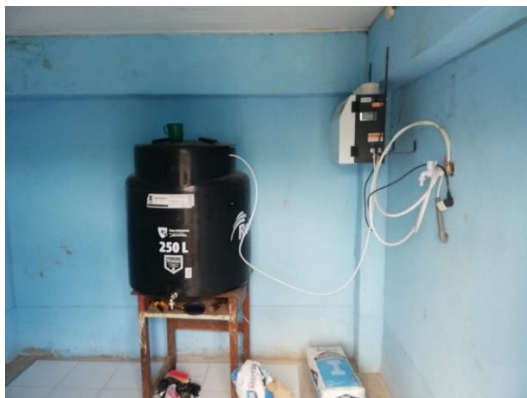
figura 7. Área donde se encuentra el sistema de osmosis inversa, ubicado en la IE My. EP Marko Emilio Jara Schenone
