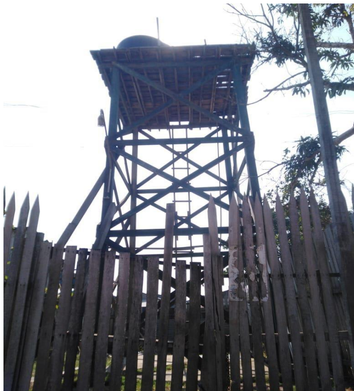
Figura 2. Pozo de abastecimiento N° 01
