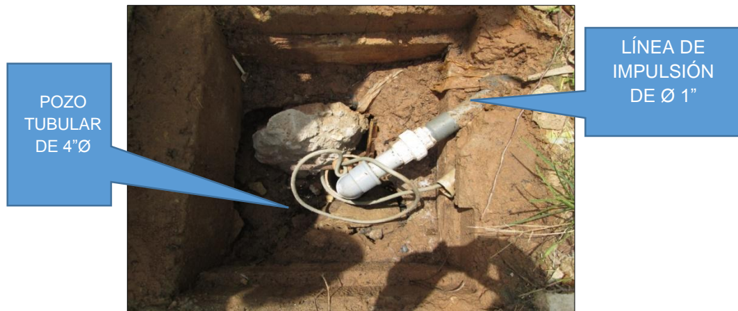
Figura 23. Pozo construido por la Municipalidad de Campo Verde
