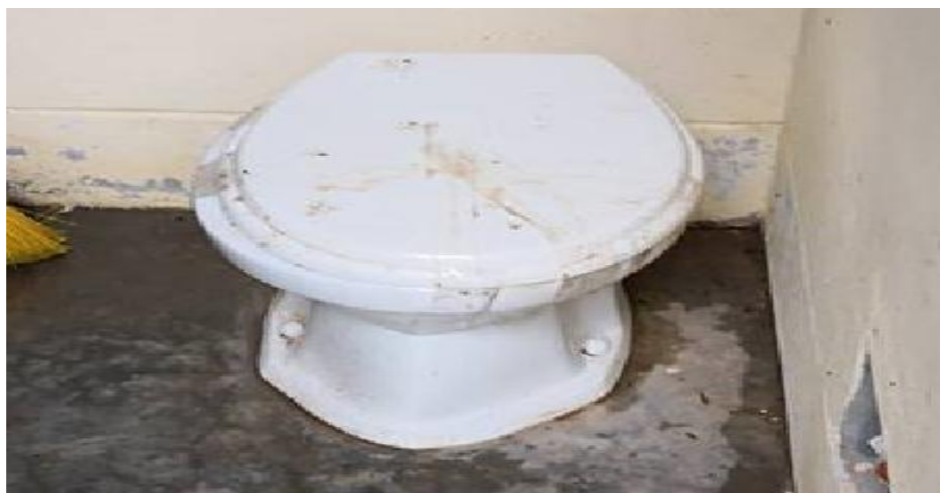
Figura 32. Vista del inodoro suspendido sellado con cinta de embalaje
