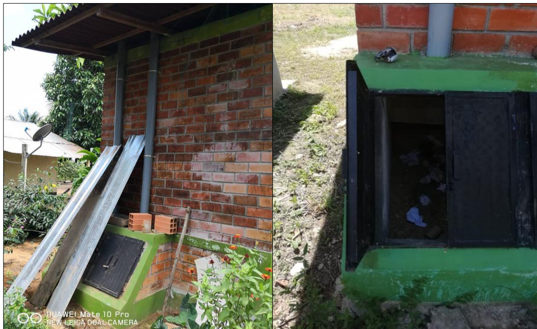
Figura 28. Vista de la caja de acumulación de excretas
