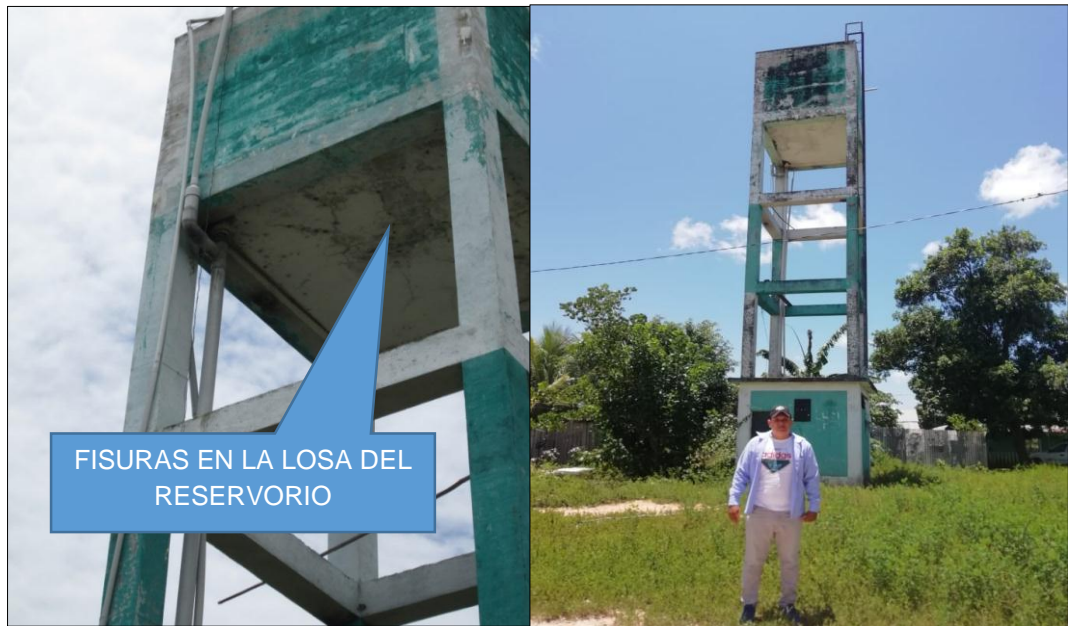
Figura 24. Características del tanque elevado del sistema 1
