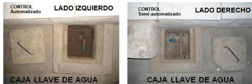
Ilustración 91: Cajas llaves de entrada de agua a las cisternas
