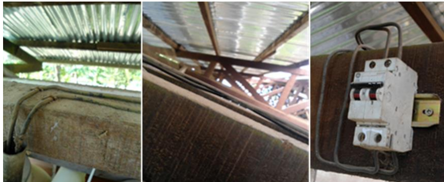
Ilustración 155: Llave general de paso de corriente o switch.
