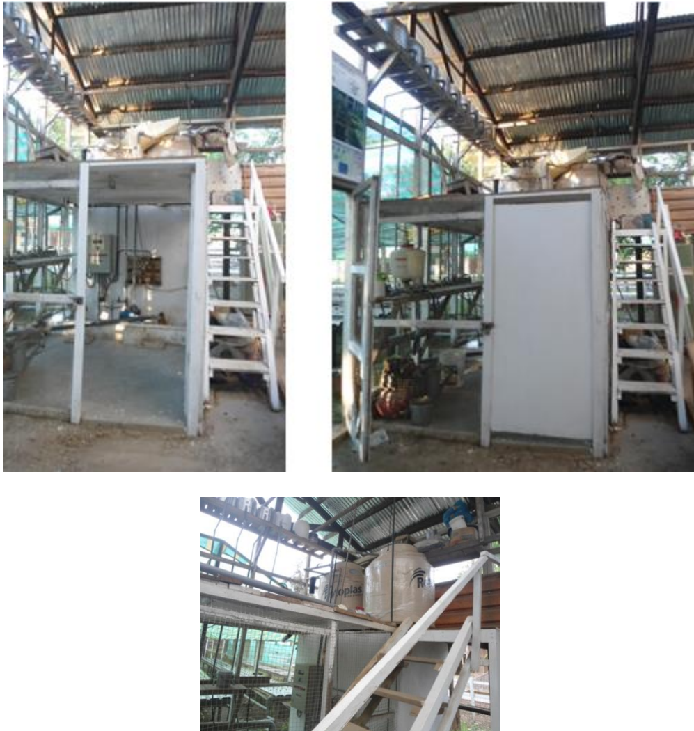
Ilustración 302: Sala o cuarto de control y operaciones
