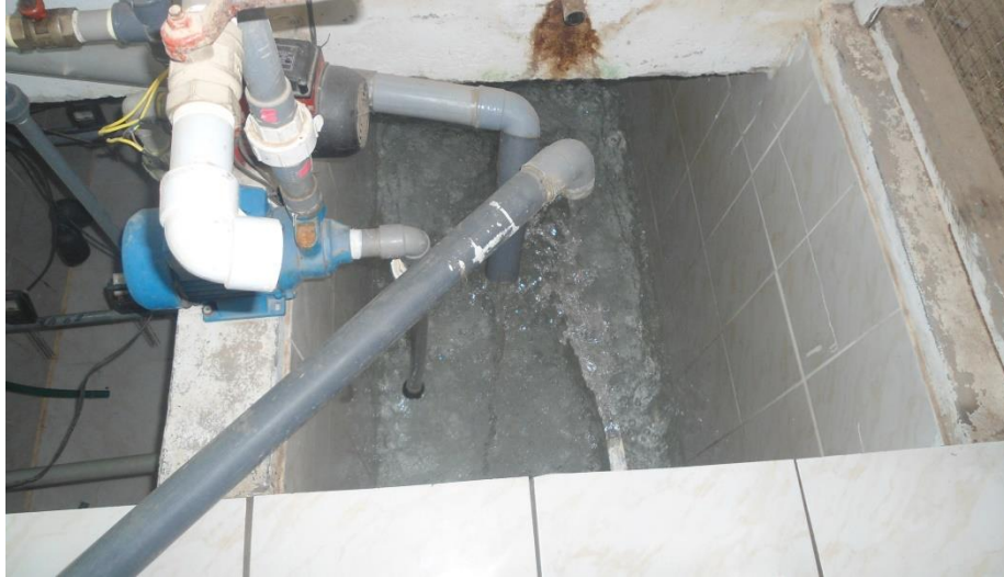
Ilustración 170: Llenado de agua al reservorio semi – automatizado
