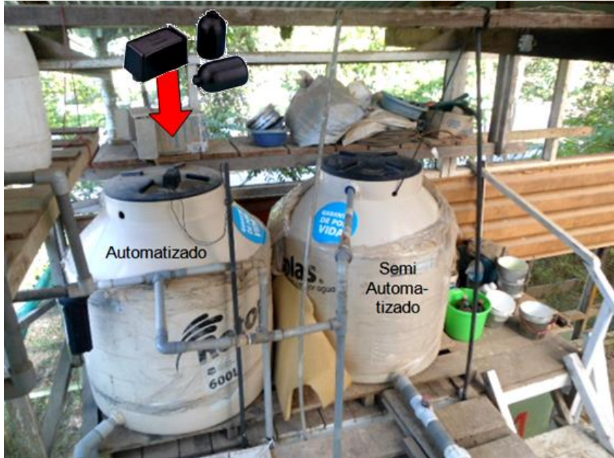
Ilustración 130: Conexión de la boya del automatizado
