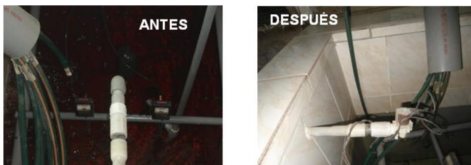
Ilustración 126: Cisterna automatizada antes y después de la instalación de la válvula solenoide
