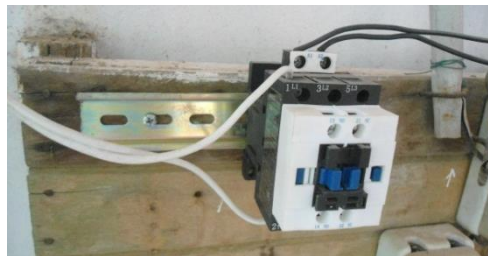
Ilustración 133: Contactor del motor Tricó
