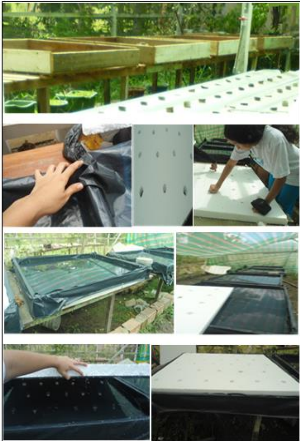
Ilustración 166: Armado de las camas del sistema hidropónico raíz flotante - sistema no automatizado
