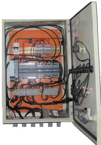
Ilustración 122: Tablero o gabinete de control del PLC
