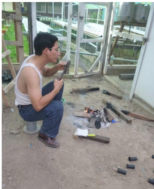
Ilustración 157: Embonados de tubos de PVC de 1" de diámetro y 8cm de longitud.
