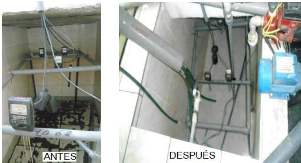
Ilustración 129: Limpieza de la cisterna subterránea para solución nutritiva del sistema automatizado
