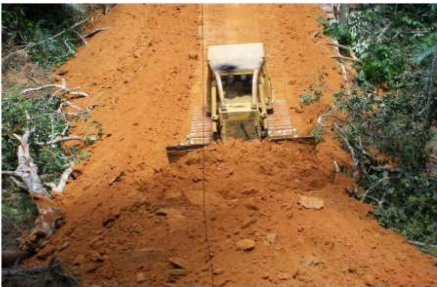
Daños al suelo por relleno.
