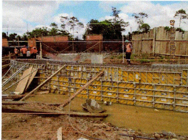
Imagen N° 44: Se muestra encofrado de muro y losa superior del canal para su vaciado monolítico.
